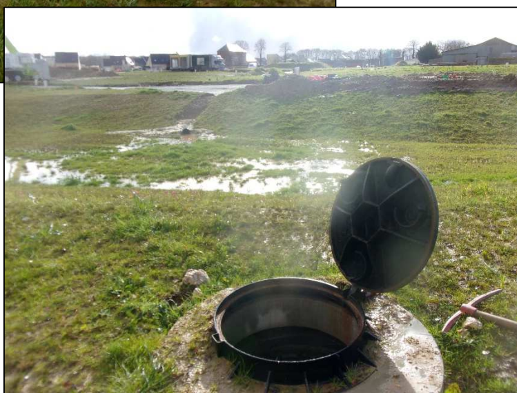
Photo 1 : Vue du bassin d'orage et de l'ouvrage de sortie du lotissement « Le Courtil des Peintres » en cours de réalisation
